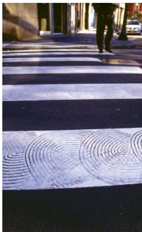
Pas de vianants amb pintura antilliscant ▶
