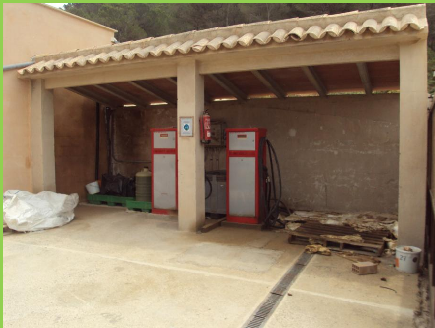
Surtidores de combustible en Cabrera
