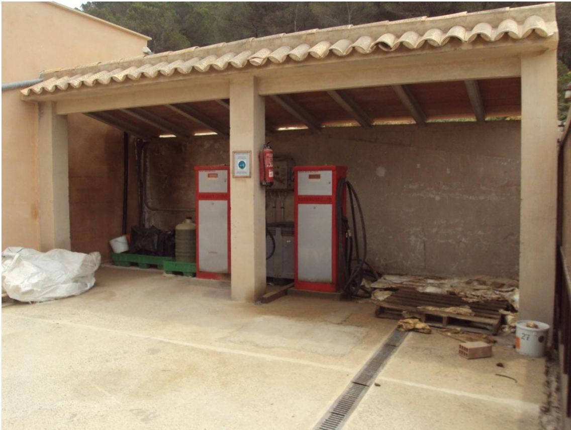
Estación de Surtidores de combustible
